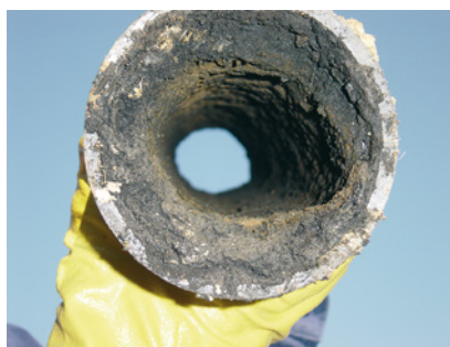
Mangan-Inkrustierung in einem ausgebauten Rohrstück.
