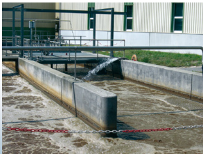
Ableitung des Spülwassers mit den gelösten Ablagerungen in die betriebs-eigene Kläranlage.
